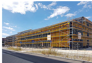
Die neue Grundschule im Wiley kann wie geplant zum neuen Schuljahr in Betrieb gehen. (Foto: Stadt Neu-Ulm)
